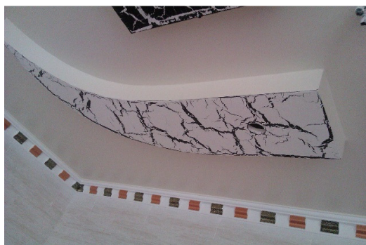
شکل ۱۲۱- نمونه اجرا شده از رنگ ترک در سقف.
